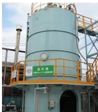
写真1 炭カル晶析槽
