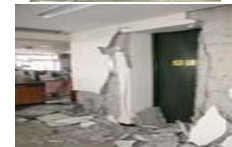
(※)東日本大震災後のA市役所の損傷状況
