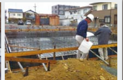
基礎配筋工の完了時 第1回目現場検査 建物の配置、基礎幅、鉄筋の結紮、基礎の高さなどをチェックします。
