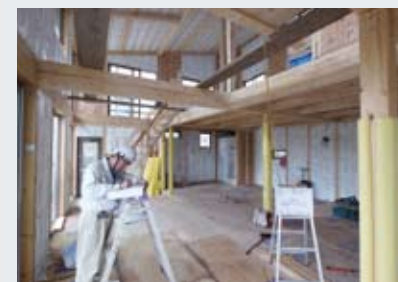
内装下地張りの直前の工事の完了時 第3回目現場検査 温熱環境に関する検査が中心です。断熱材、防湿フィルム等の施工状況、開口部の断熱性能、日射取得などをチェックします。
