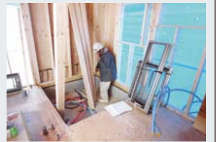
躯体工の完了後 第2回目現場検査 躯体に関しては、特に時間をかけて綿密にチェックします。評価員の目視、計測だけで把握できないものには、部材メーカーが発行した納品書、認定書などを提示してもらいます。
