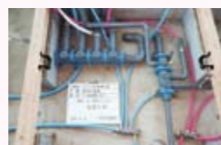
メンテナンス性の高い集中配管
