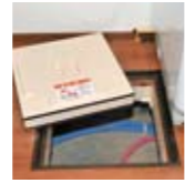
メンテナンス用の点検口にもしっかり断熱加工。
