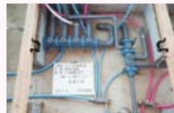
メンテナンス性の高い集中配管
